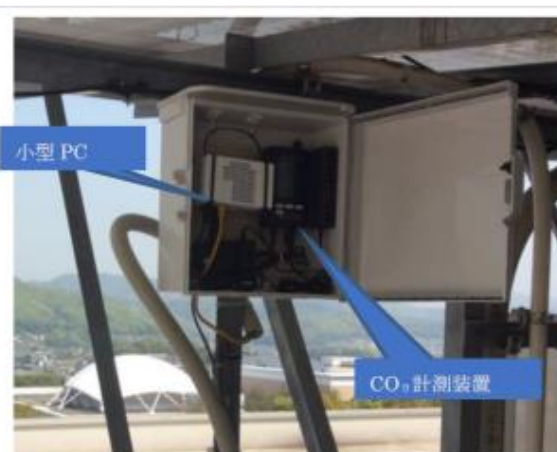
図 2 福山大学工学部屋上のセンサーユニット
